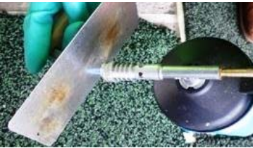
Glättkelle anwärmen, z.B. mit einem Gaskartuschen-Brenner, und mit leichtem Druck die Beschichtung an der Oberfläche verpressen
